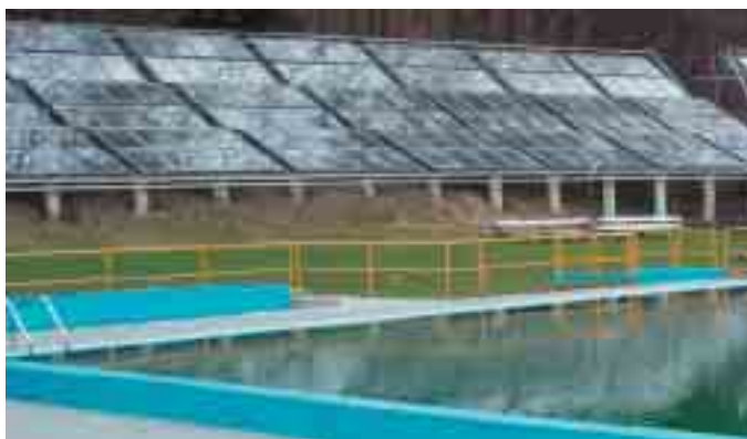
Západní sekce kolektorového pole na koupališti Rusava
