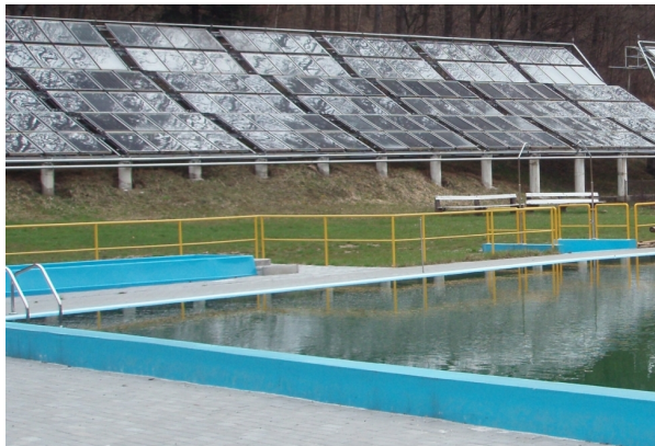
Obrázek 13: západní sekce kolektorového pole
