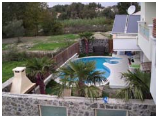
Εικόνα 2 Επίπεδοι συλλέκτες για θέρμανση κολυμβητικής δεξαμενής στην Κέρκυρα
